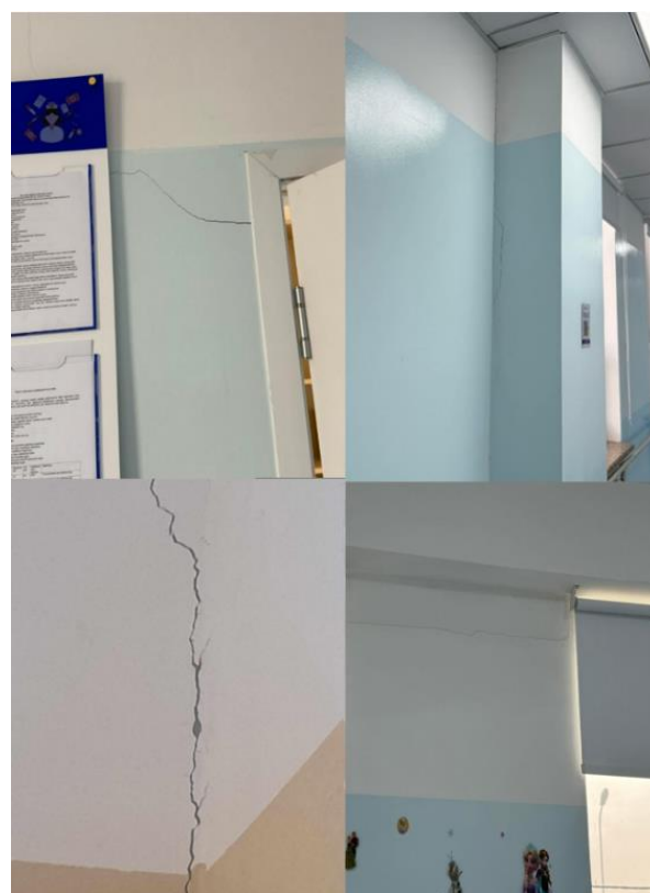
Зураг 14. Хүрмэн сумын ЭМТөвийн барилга болон дотуур байрны хананд үүссэн цууралтууд
